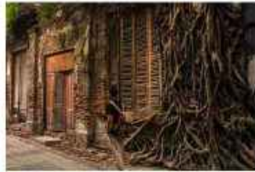
Gambar 4. 2 Akar tanaman yang tumbuh di Bangunan Cagar Budaya dapat menyebabkan kerusakan pada dinding bata
