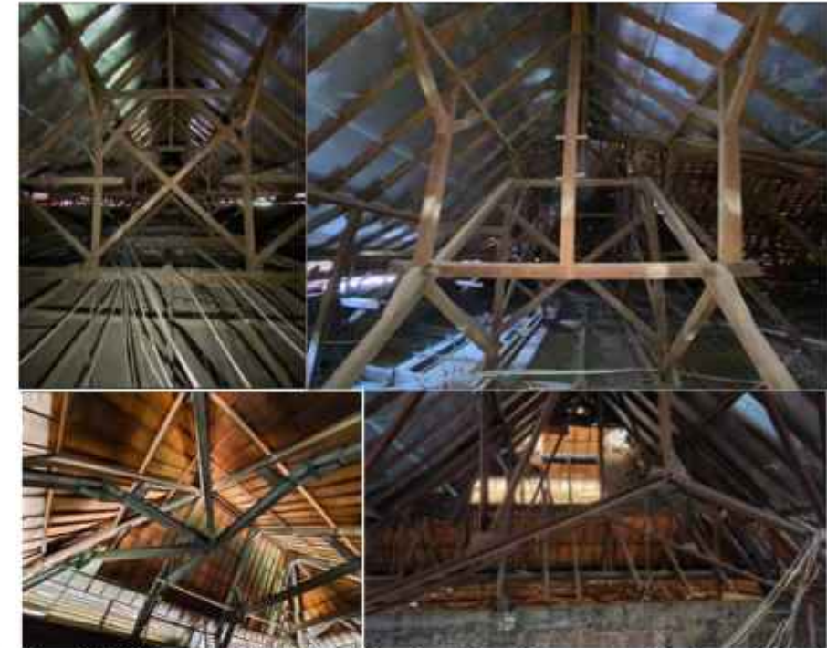
Gambar 3. 18 Kondisi Struktur Rangka Atap Bangunan Gedung NIAS
